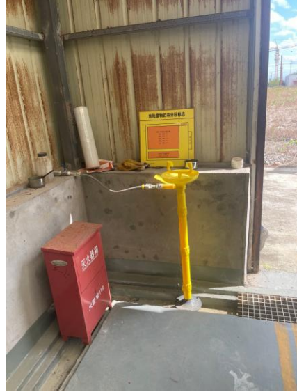
危废仓库四周导流槽
